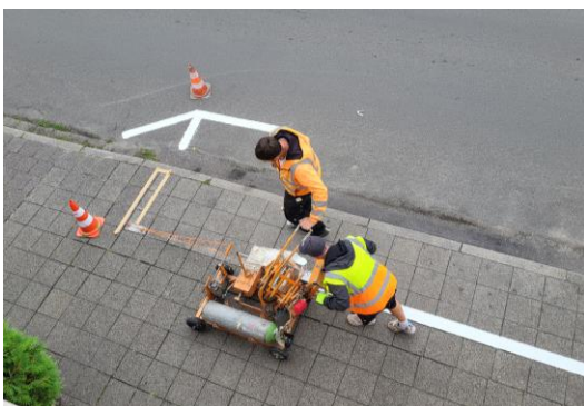
Abbildung 10 Neumarkierung von bestehendem Gehwegparken
