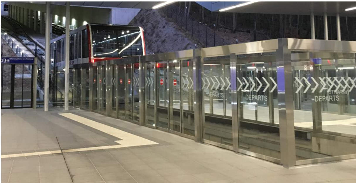
Abb. 17: Beispiel für gläserne Perrontüren, Standseilbahn Luxemburg (Quelle: Garaventa)
