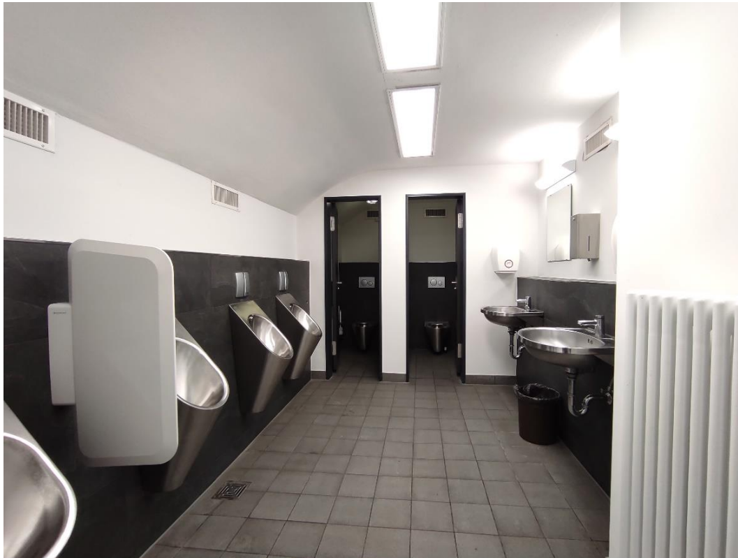
Rathaus öffentliche WC-Anlage der Herren wurde in 2020 Vandalismussicher erledigt
