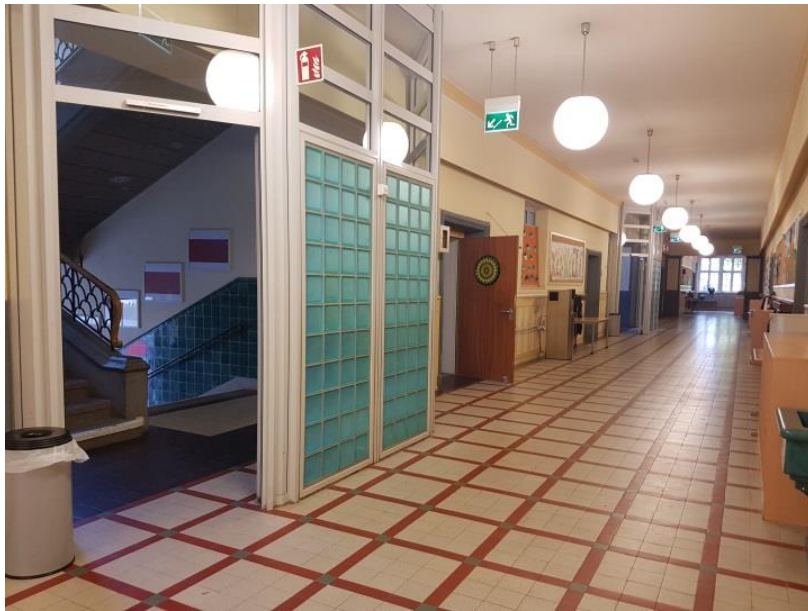
Pestalozzischule Flur-Abtrennungen vorher
